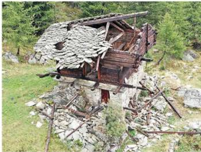
Il tetto dello stadel di Stubbi è crollato lo scorso anno
